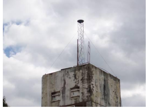
Estructura metálica empotrada en el tanque de agua de la Municipalidad de San Vicente, Misiones.
