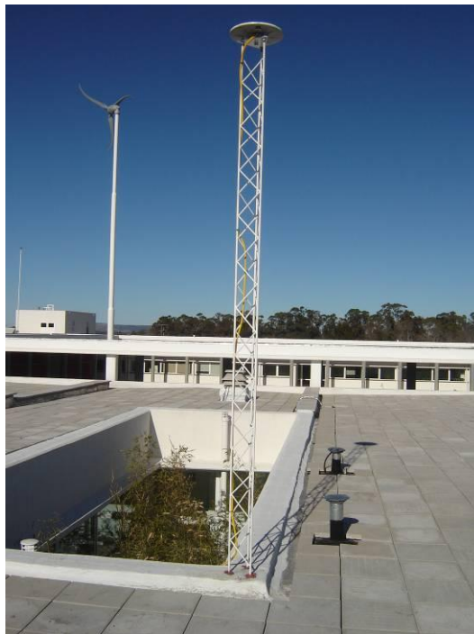
Estructura metálica empotrada en la terraza del INTA sede Balcarce, Buenos Aires.
